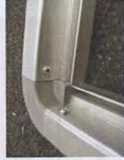
Foto B: porta-montante centrale e montante centrale
